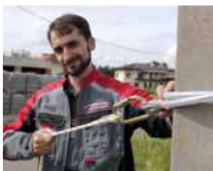
Анкерная точка на опоре электропередач.
